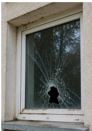
Photo #7. Poškodené okno zdokumentované na vyhodnotenie
