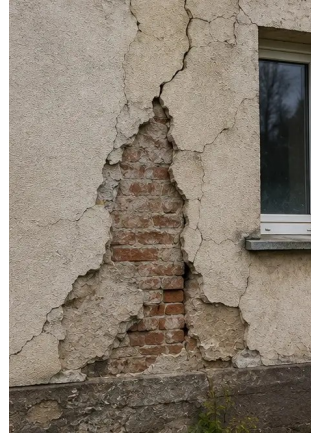
Photo #4. Poškodenie vonkajšej steny zdokumentované na posúdenie
