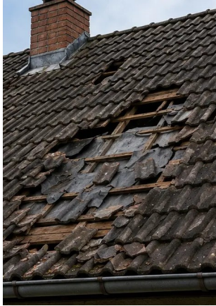
Photo #3. Poškodená oblasť strechy identifikovaná a zaznamenaná
