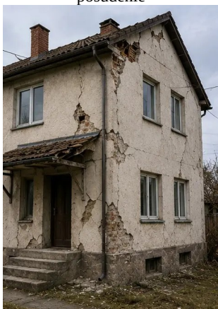
Photo #15. Prehľad viacerých miest poškodenia
