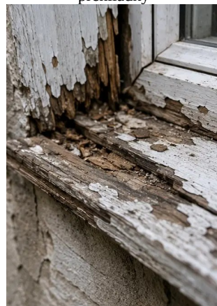
Photo #14. Fotografia detailu identifikovaného poškodenia
