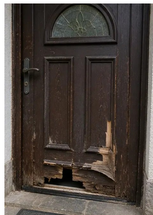
Photo #8. Poškodené vchodové dvere zaznamenané počas prehliadky
