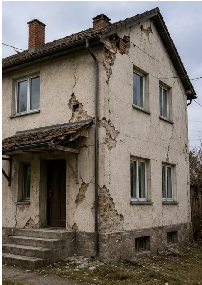
Fotografia č. 15 Prehľad viacerých miest poškodenia
