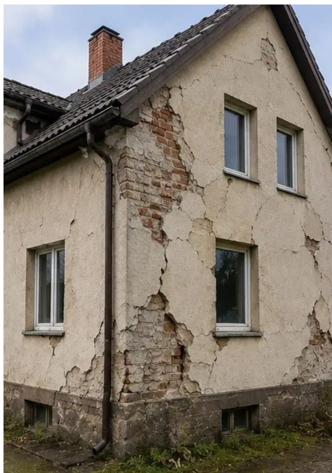
Fotografia č. 2 Prehľad vonkajších poškodení zdokumentovaných počas prehliadky
