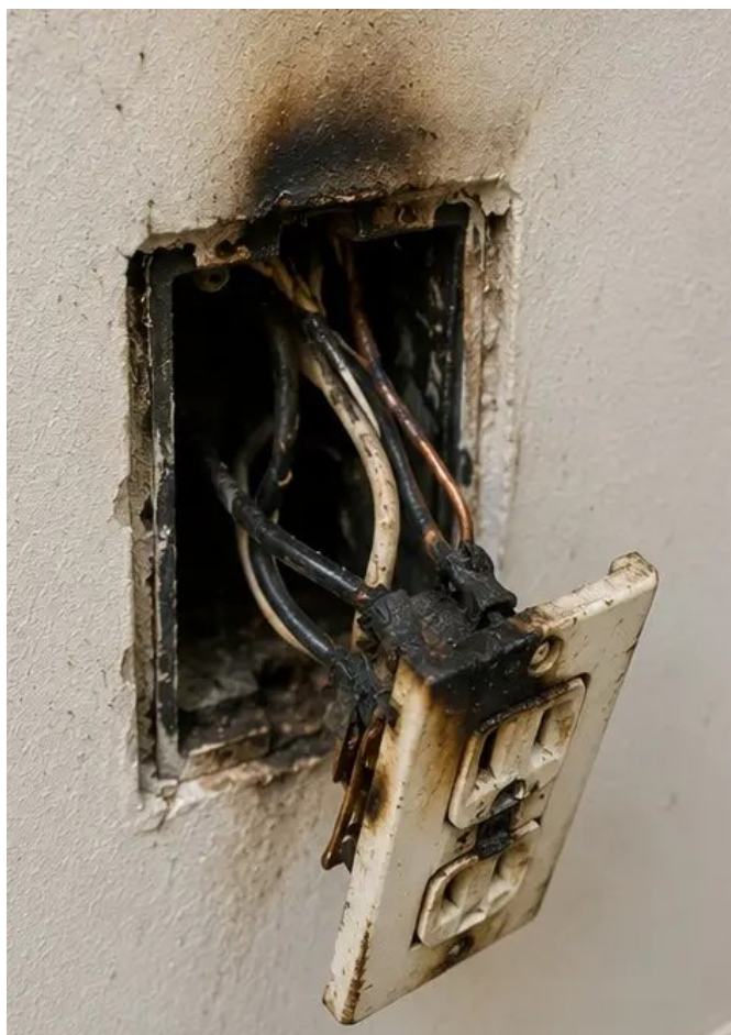
Fotografia č. 12 Poškodenie elektrického systému zaznamenané počas prehliadky
