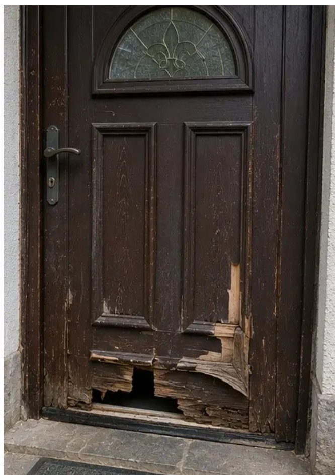
Fotografia č. 8 Poškodené vchodové dvere zaznamenané počas prehliadky
