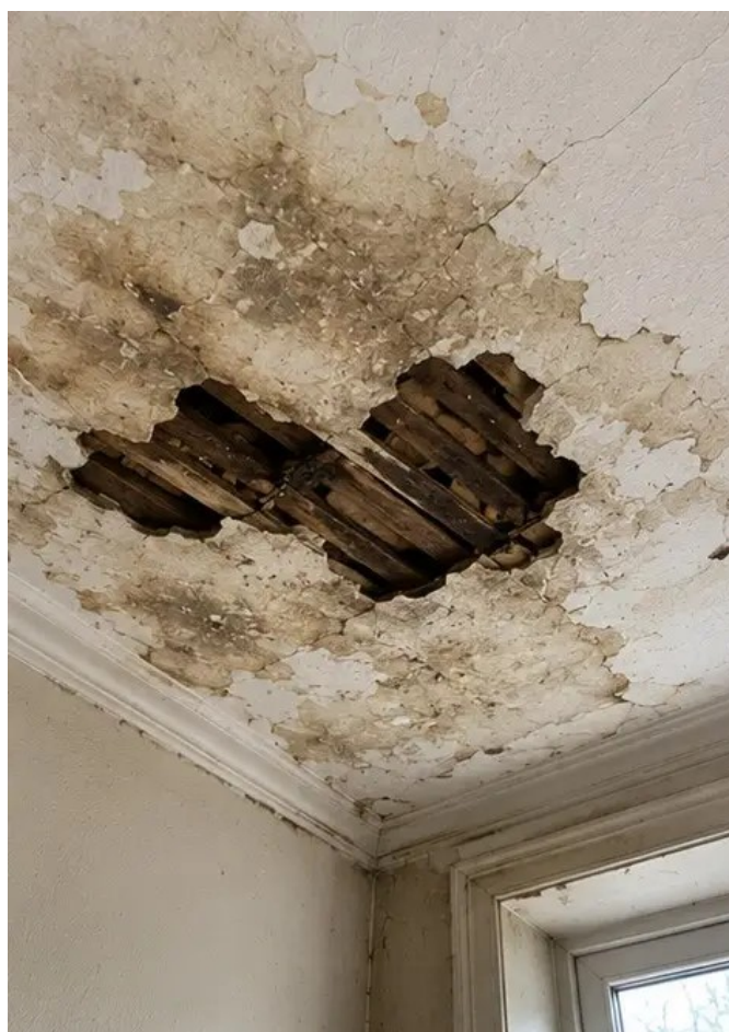
Fotografia č. 10 Poškodenie stropu identifikované a zaznamenané
