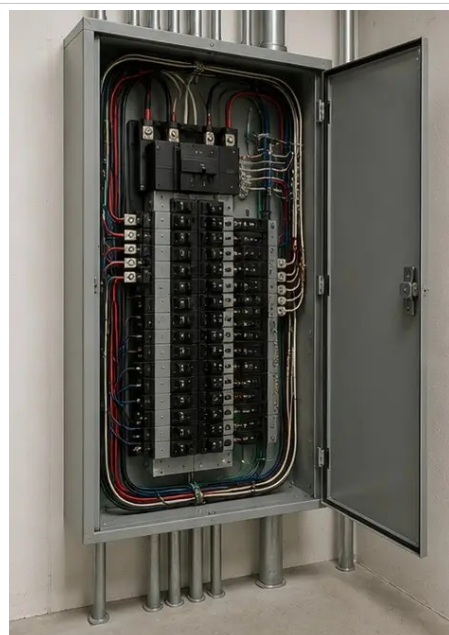
Photo #9. Stav elektrického rozvádzača zdokumentovaný
