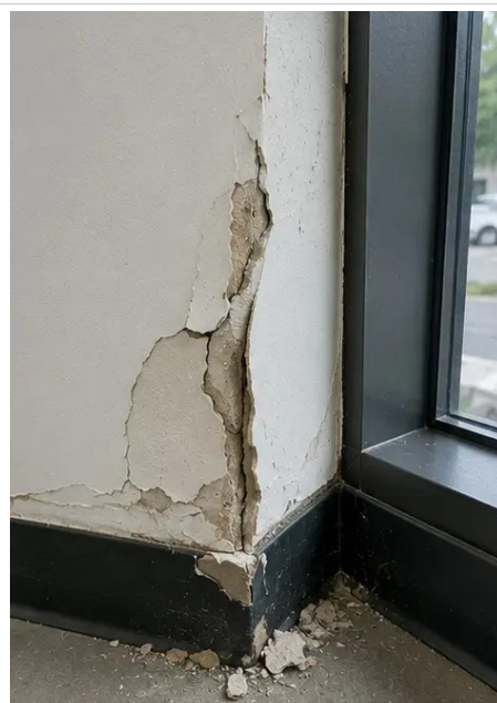
Photo #15. Identifikovaná oblasť s poruchou zdokumentovaná na ďalšie vyhodnotenie
