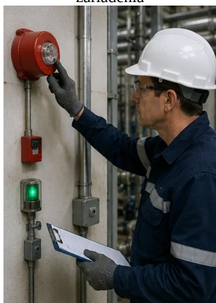
Fotografia č. 13. Kontrola bezpečnostného systému dokončená
