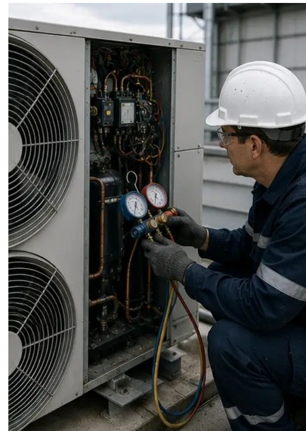
Fotografia č. 6. Stav zariadenia HVAC zdokumentovaný
