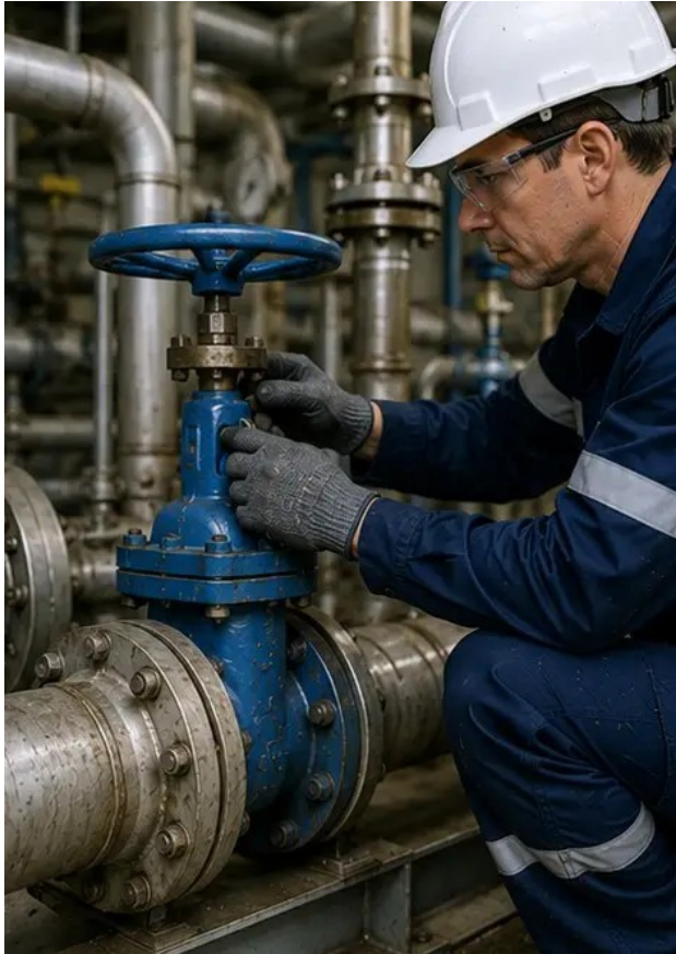
Fotografia č. 10. Stav ventilu posúdený počas kontroly
