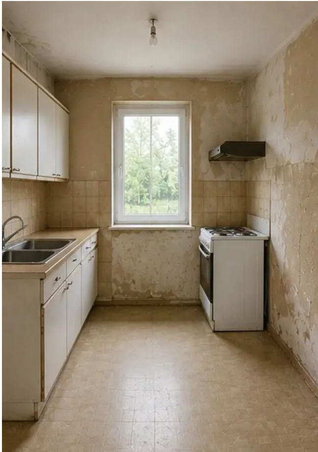
Fotografia č. 11 Stav kuchyne pred rekonštrukciou
