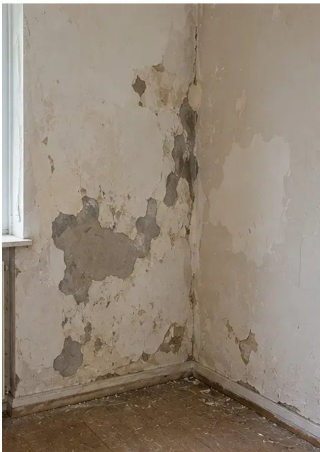
Fotografia č. 3 Stav steny pred opravnými prácami
