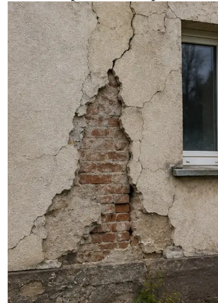
Photo #4. Повреждение наружной стены задокументировано для оценки
