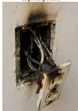
Photo #12. Повреждение электрической системы зафиксировано во время осмотра
