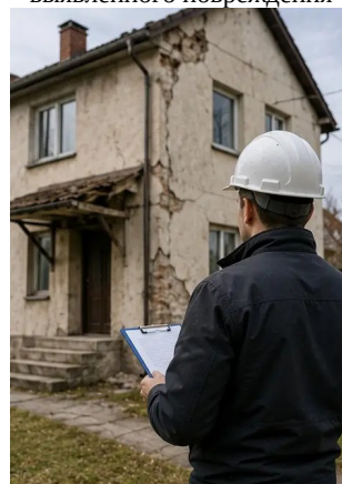
Photo #16. Итоговая фотография осмотра повреждений
