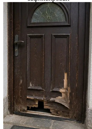
Photo #8. Поврежденная входная дверь зафиксирована во время осмотра
