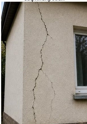
Photo #5. Трещина в несущей стене задокументирована во время осмотра
