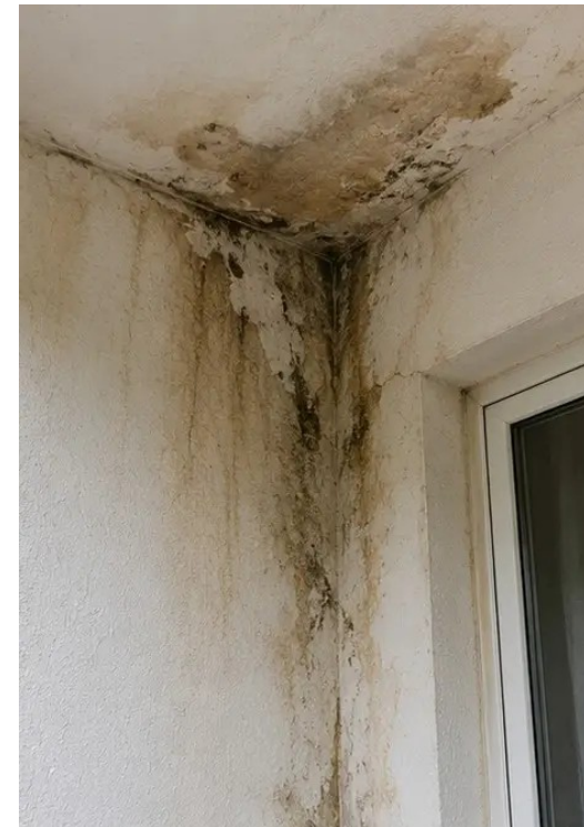
Фото №6 Участок повреждения водой идентифицирован и зафиксирован
