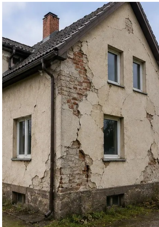
Фото №2 Обзор внешних повреждений, задокументированных во время осмотра
