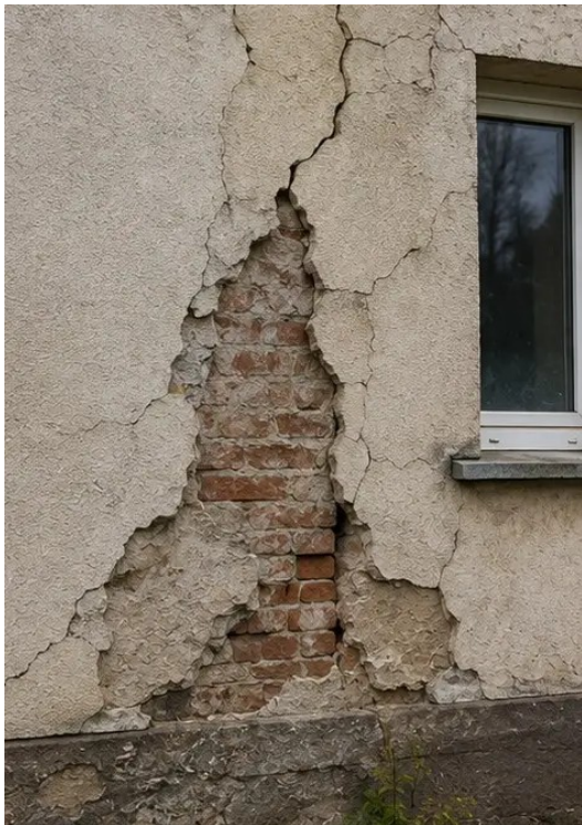
Фото №4 Повреждение наружной стены задокументировано для оценки
