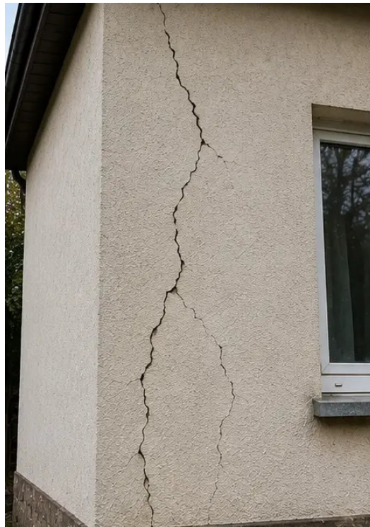
Фото №5 Трещина в несущей стене задокументирована во время осмотра
