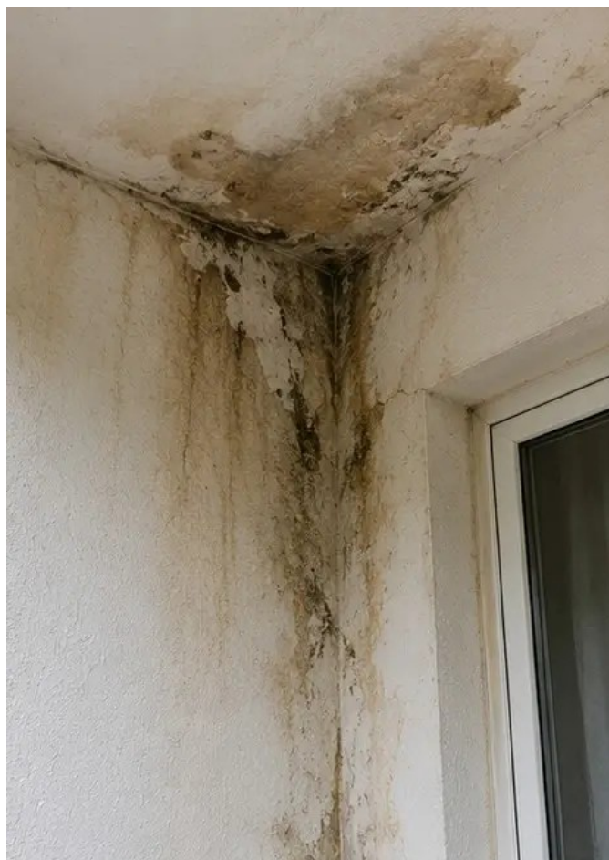
Фото №6 Участок повреждения водой идентифицирован и зафиксирован
