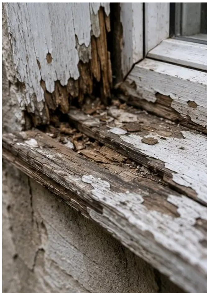
Фото №14 Фото крупным планом в качестве доказательства выявленного повреждения
