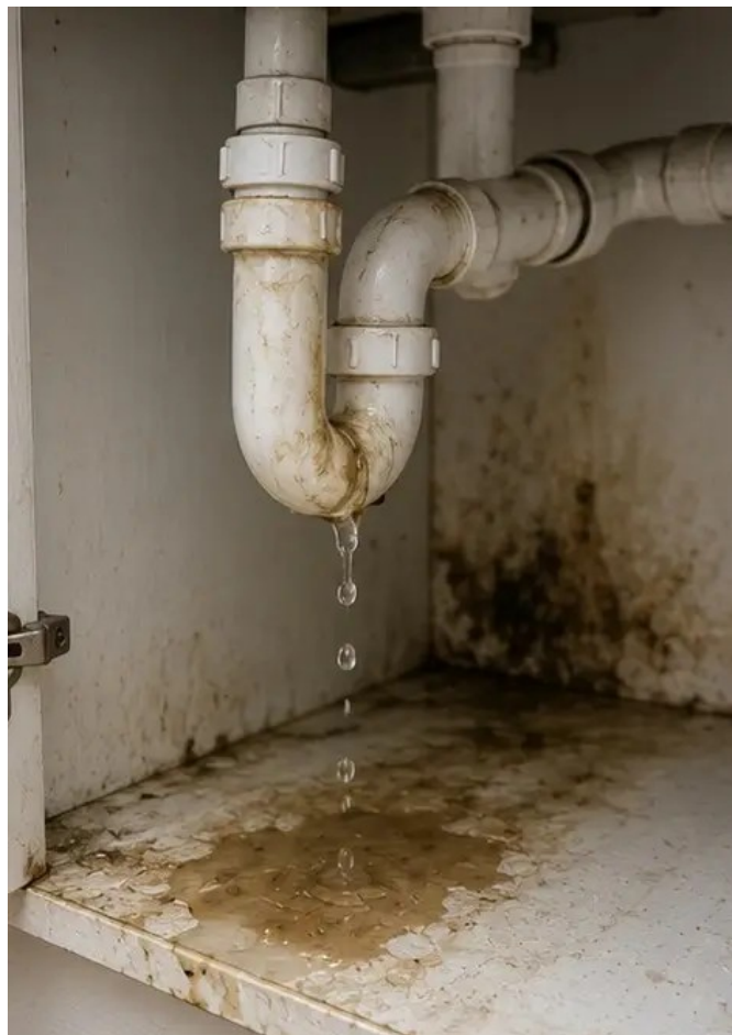
Фото №11 Повреждение от протечки сантехники задокументировано
