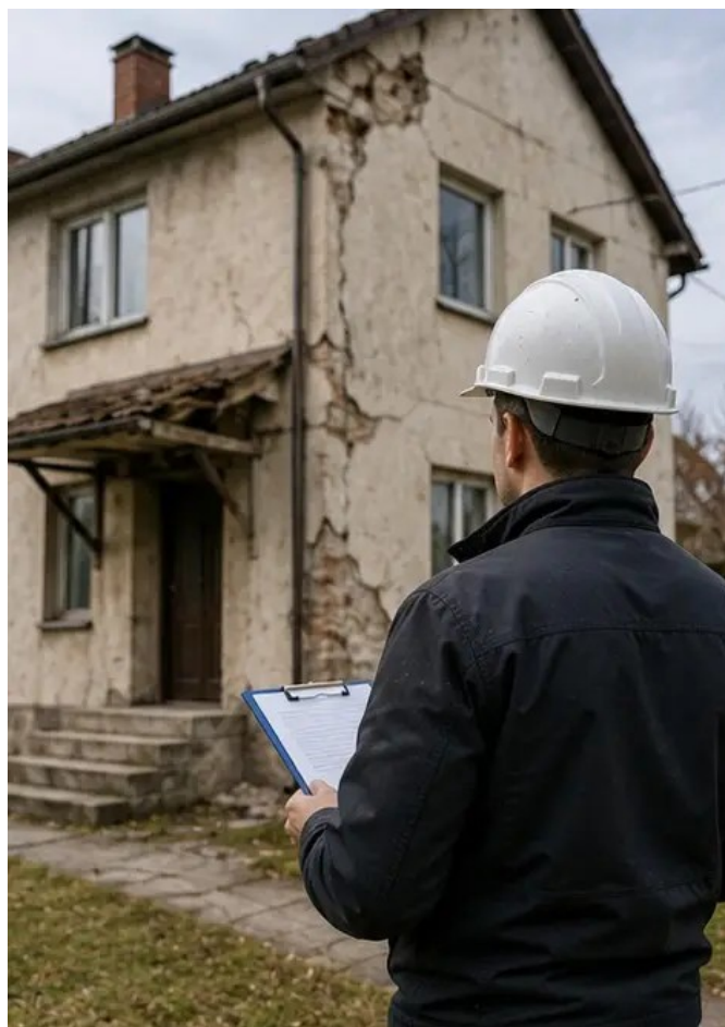
Фото №16 Итоговая фотография осмотра повреждений
