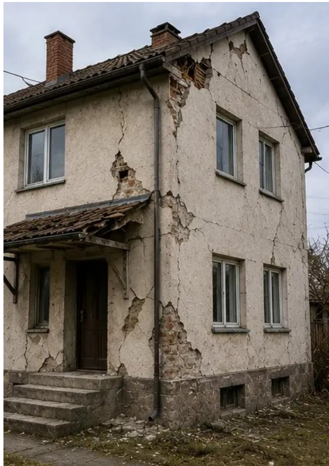
Фото №15 Обзор нескольких мест повреждений
