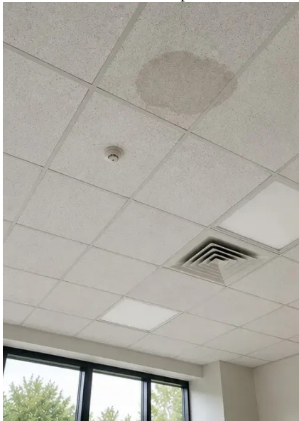
Photo #13. Состояние потолка задокументировано во время осмотра
