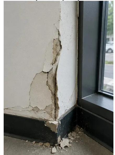
Photo #15. Выявленная дефектная зона задокументирована для дальнейшей оценки
