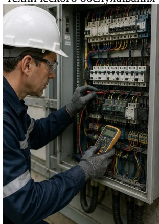
Фото №5. Осмотр электрического шкафа выполнен
