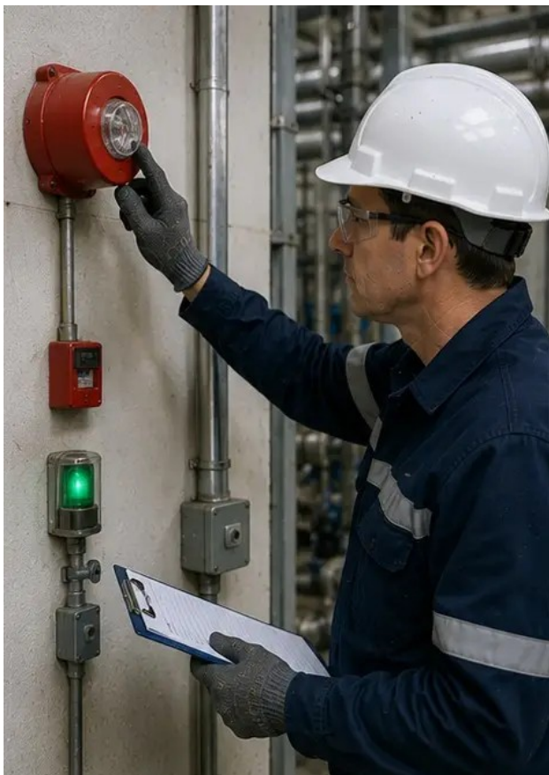
Фото №13. Осмотр системы безопасности завершен
