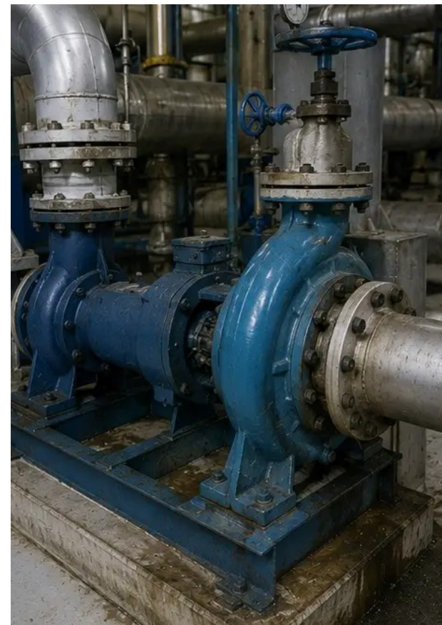
Фото №3. Состояние промышленного насоса оценено во время технического обслуживания
