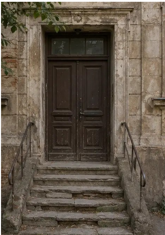
Фото №15 Вход на объект до улучшения
