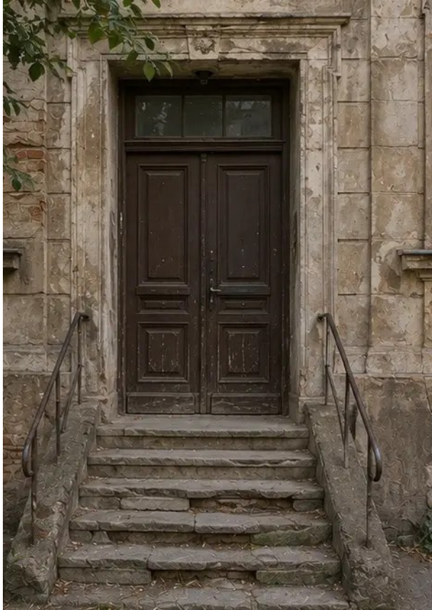
Фото №15 Вход на объект до улучшения
