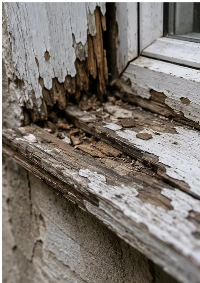
Foto nr.14 Fotografie de detaliu a dovezii daunei identificate
