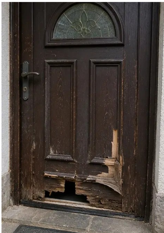
Foto nr.8 Ușă de intrare deteriorată înregistrată în timpul inspecției
