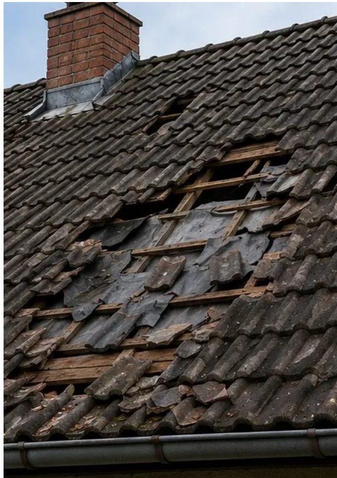
Foto nr.3 Zonă de acoperiș deteriorată identificată și înregistrată
