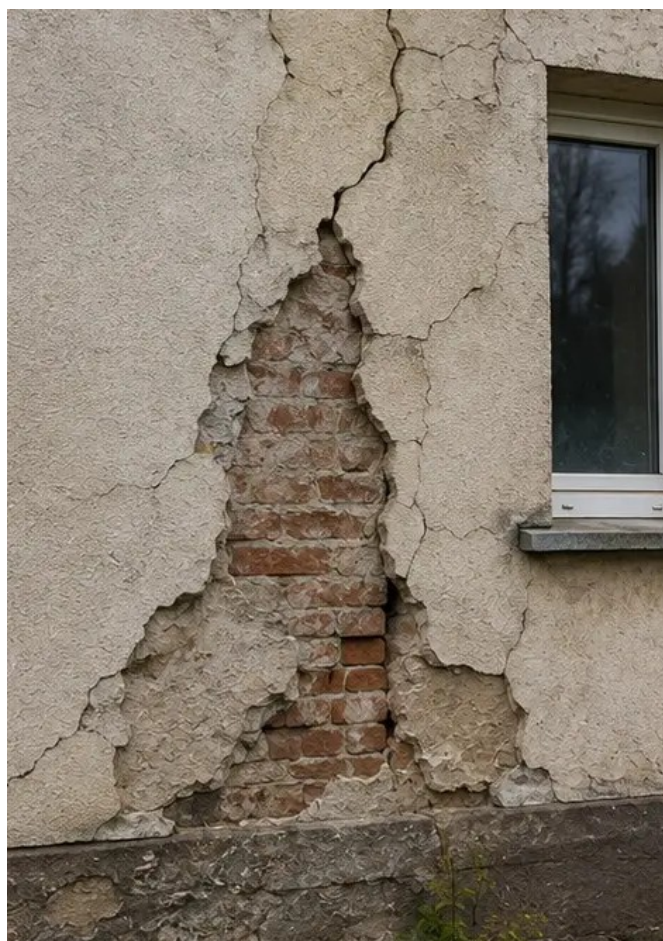
Foto nr.4 Deteriorarea peretelui exterior documentată pentru evaluare
