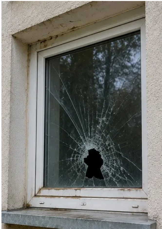
Foto nr.7 Fereastră deteriorată documentată pentru evaluare
