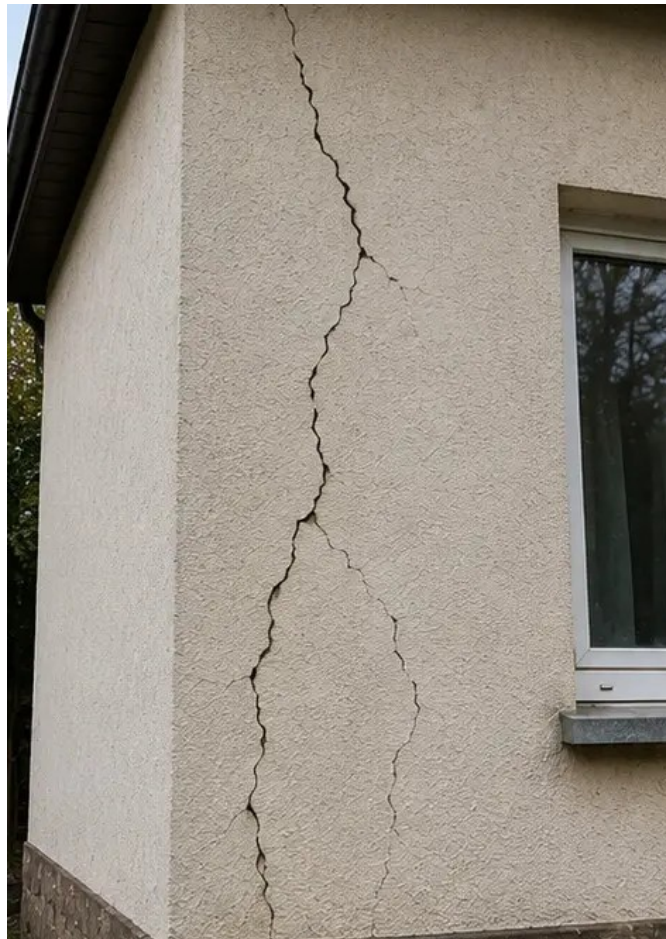
Foto nr.5 Fisură în perete structural documentată în timpul inspecției
