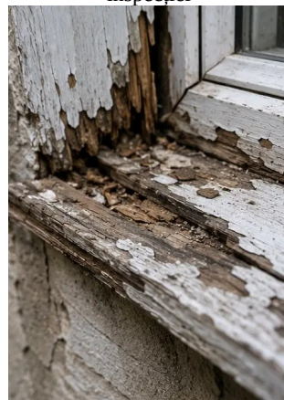
Photo #14. Fotografie de detaliu a dovezii daunei identificate
