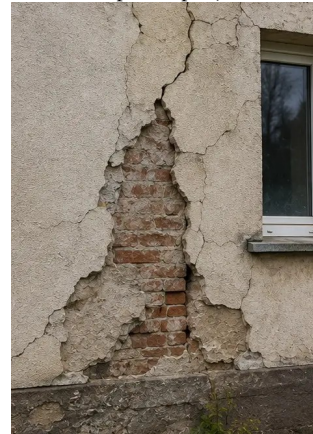
Photo #4. Deteriorarea peretelui exterior documentată pentru evaluare
