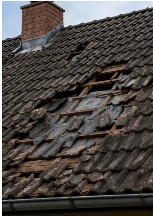
Photo #3. Zonă de acoperiș deteriorată identificată și înregistrată
