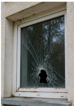
Photo #7. Fereastră deteriorată documentată pentru evaluare
