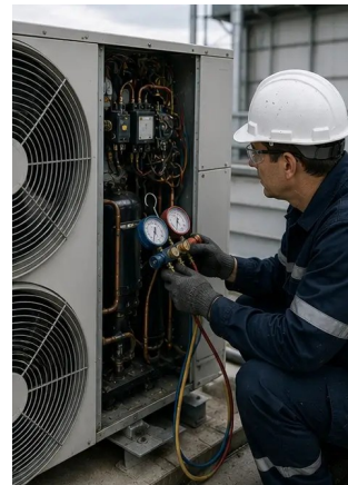
Foto nr.6. Starea echipamentului HVAC documentată
