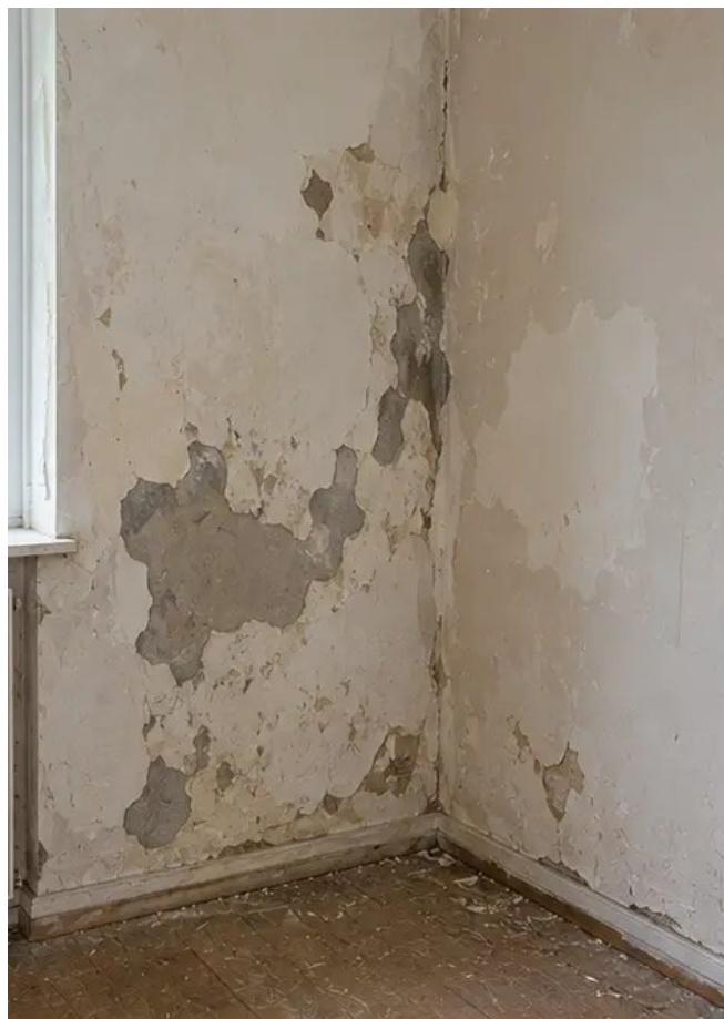
Foto nr.3 Starea peretelui înainte de lucrările de reparație
