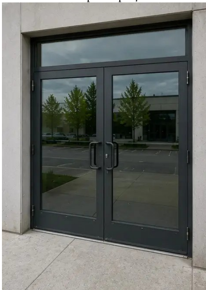
Photo #7. Starea ușilor inspectată și înregistrată
