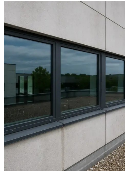
Photo #6. Starea ferestrelor documentată în timpul inspecției
