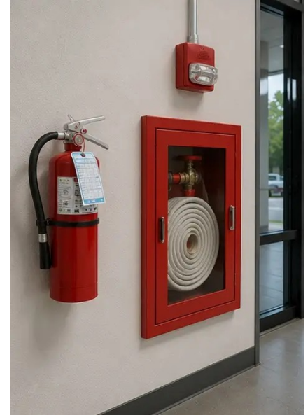
Photo #12. Echipamentul de siguranță inspectat și înregistrat
