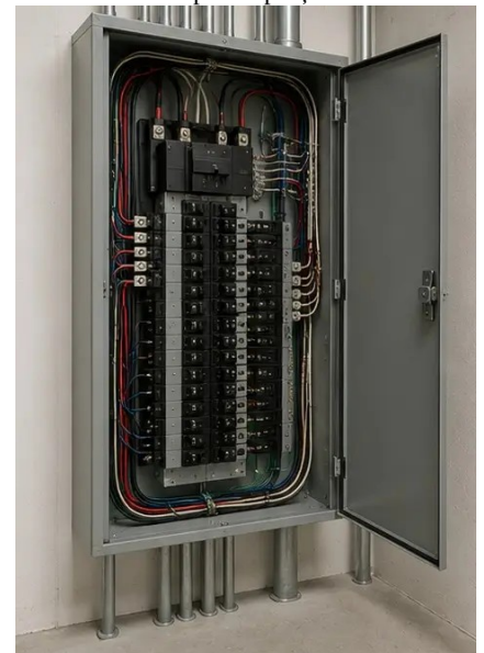
Photo #9. Starea tabloului electric documentată
