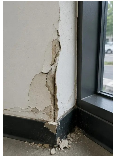
Photo #15. Zona defectă identificată documentată pentru evaluare ulterioară
