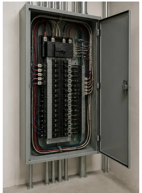
Photo #9. Starea tabloului electric documentată
