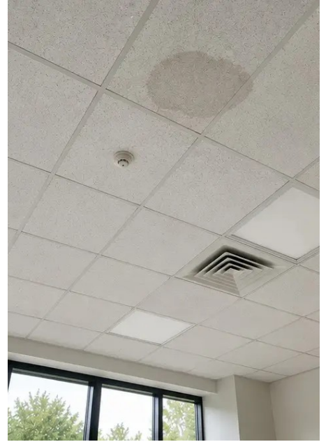
Photo #13. Starea tavanului documentată în timpul inspecției
