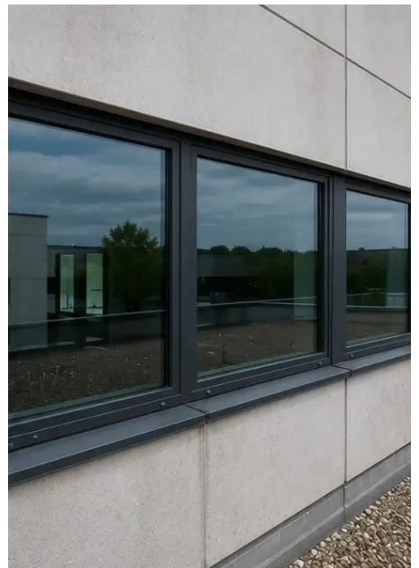
Photo #6. Starea ferestrelor documentată în timpul inspecției
