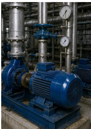
Foto nº15. Equipamento a funcionar normalmente após a manutenção
