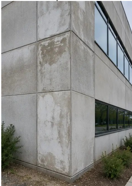
Photo #4. Estado das paredes exteriores registado durante a inspeção
