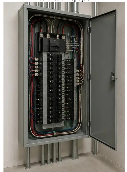
Photo #9. Estado do quadro elétrico documentado
