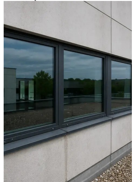
Photo #6. Estado das janelas documentado durante a inspeção
