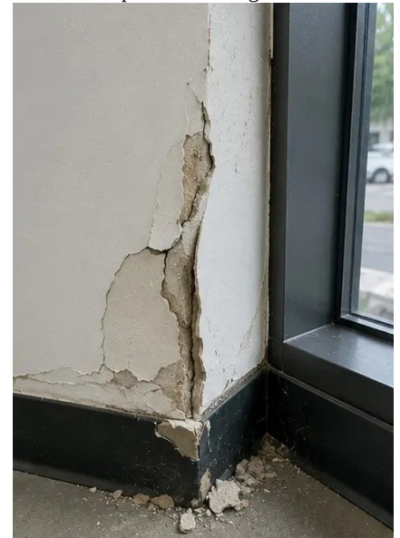
Photo #15. Área de defeito identificada documentada para avaliação adicional
