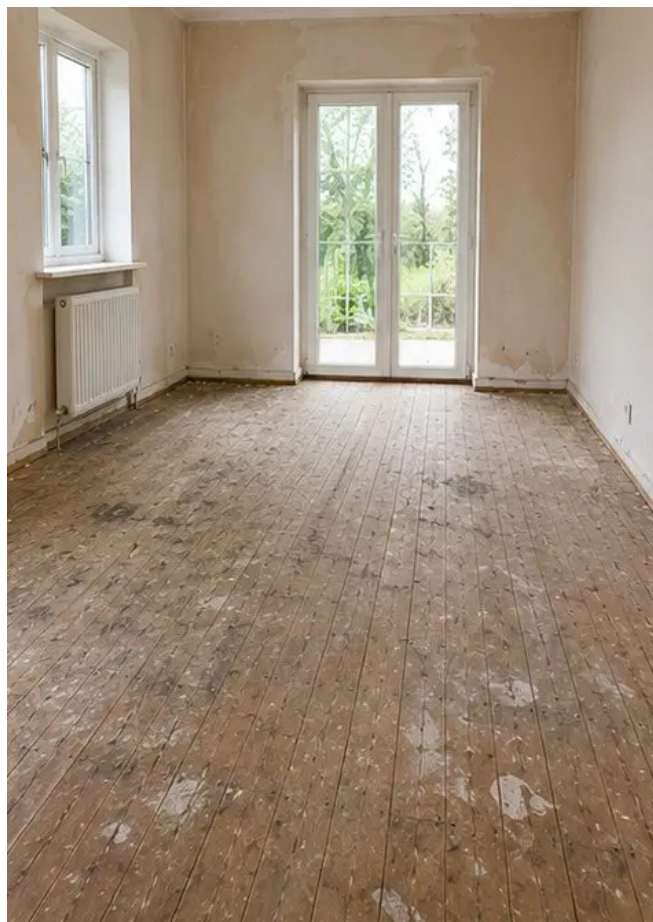
Foto n°5 Estado do pavimento antes da substituição
