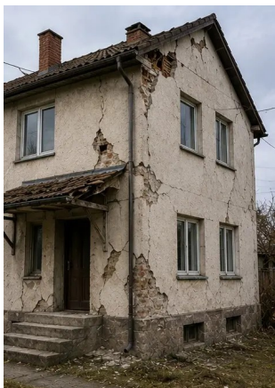
Photo #15. Visão geral de várias localizações de danos
