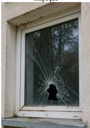
Photo #7. Janela danificada documentada para avaliação
