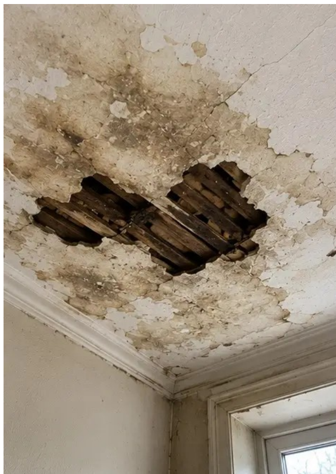
Foto n°10 Dano no teto identificado e registado
