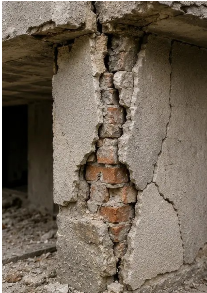
Foto nº13 Detalhe do dano estrutural documentado para avaliação
