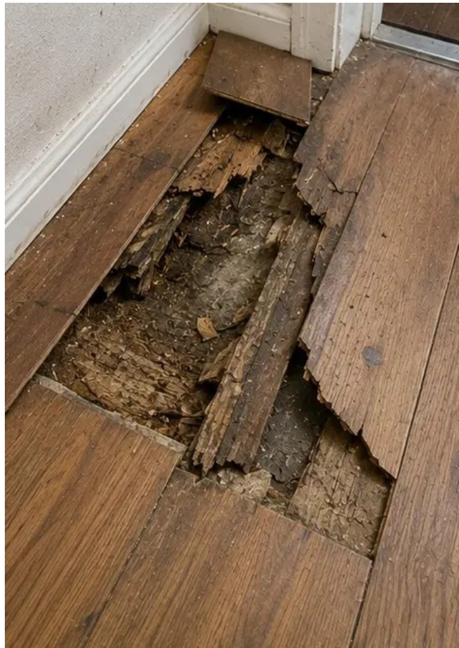
Foto n°9 Pavimento danificado documentado durante a inspeção
