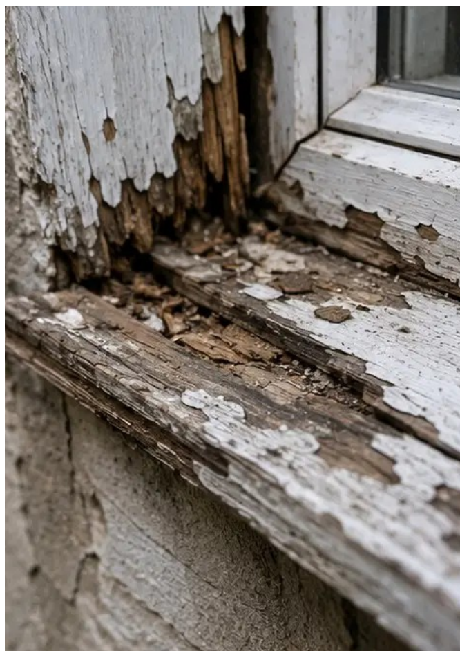
Foto nº14 Fotografia de pormenor do dano identificado como prova
