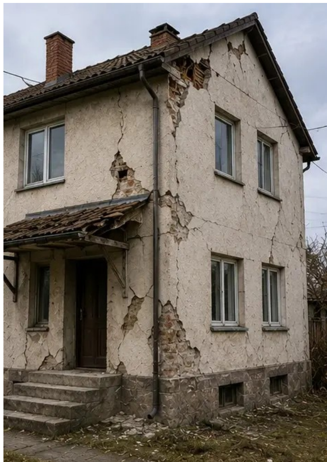
Foto n°15 Visão geral de várias localizações de danos
