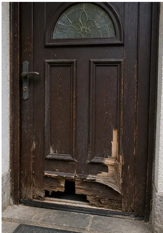
Foto n°8 Porta de entrada danificada registada durante a inspeção
