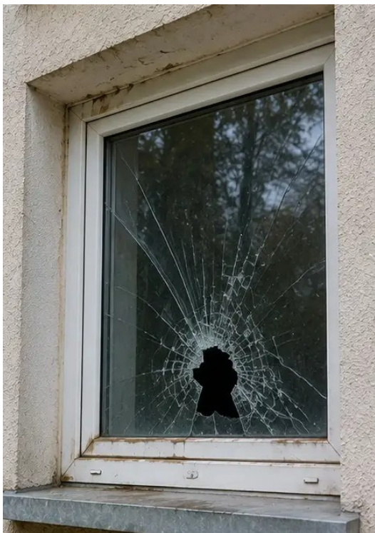
Foto n°7 Janela danificada documentada para avaliação
