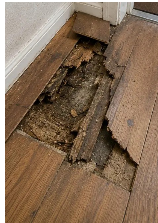
Foto n°9 Pavimento danificado documentado durante a inspeção
