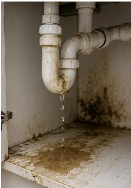
Foto nº11 Danos por fuga na canalização documentado
