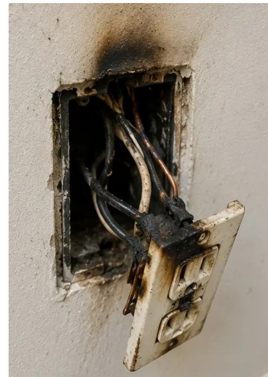
Foto nº12 Danos no sistema elétrico registado durante a inspeção
