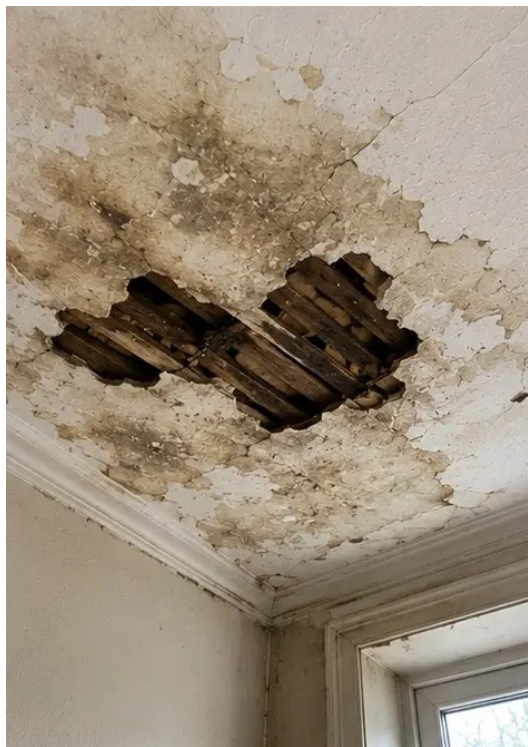
Foto nº10 Danos no teto identificado e registado
