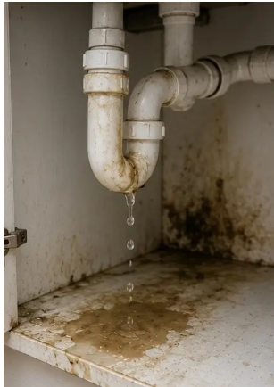
Photo #11. Uszkodzenie spowodowane wyciekami z instalacji wodnej udokumentowane
