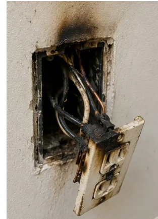
Photo #12. Uszkodzenie instalacji elektrycznej odnotowane podczas inspekcji
