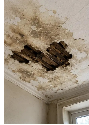
Photo #10. Uszkodzenie sufitu zidentyfikowane i odnotowane
