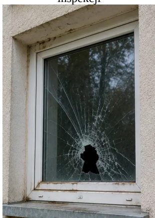
Photo #7. Uszkodzone okno udokumentowane do oceny
