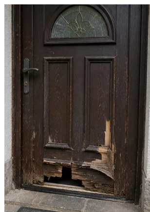
Photo #8. Uszkodzone drzwi wejściowe odnotowane podczas inspekcji
