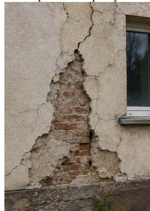
Photo #4. Uszkodzenie ściany zewnętrznej udokumentowane do oceny
