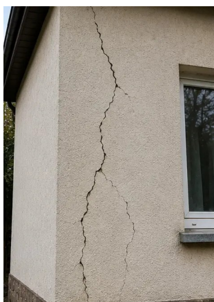
Photo #5. Pęknięcie ściany konstrukcyjnej udokumentowane podczas inspekcji
