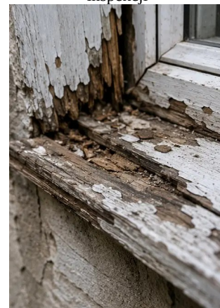
Photo #14. Zbliżenie fotograficzne dowodu zidentyfikowanego uszkodzenia
