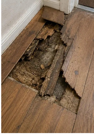
Photo #9. Uszkodzona podłoga udokumentowana podczas inspekcji
