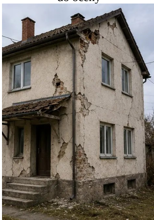
Photo #15. Przegląd wielu lokalizacji uszkodzeń
