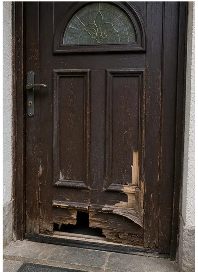
Dokumentacja fotograficzna №8 Uszkodzone drzwi wejściowe odnotowane podczas inspekcji
