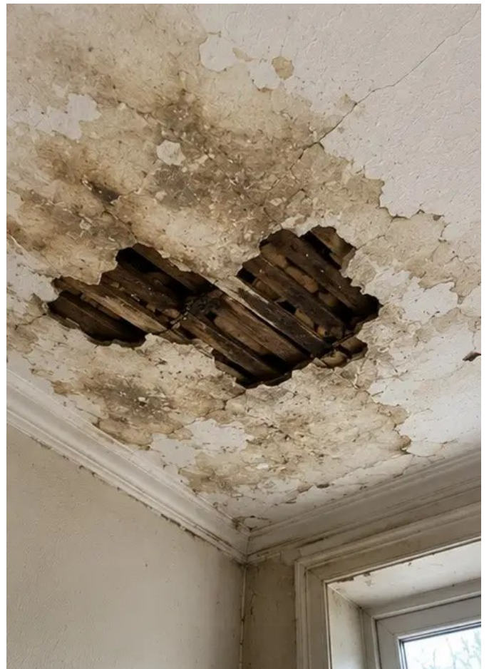
Dokumentacja fotograficzna №10 Uszkodzenie sufitu zidentyfikowane i odnotowane
