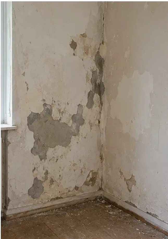
Dokumentacja fotograficzna №3 Stan ściany przed naprawą
