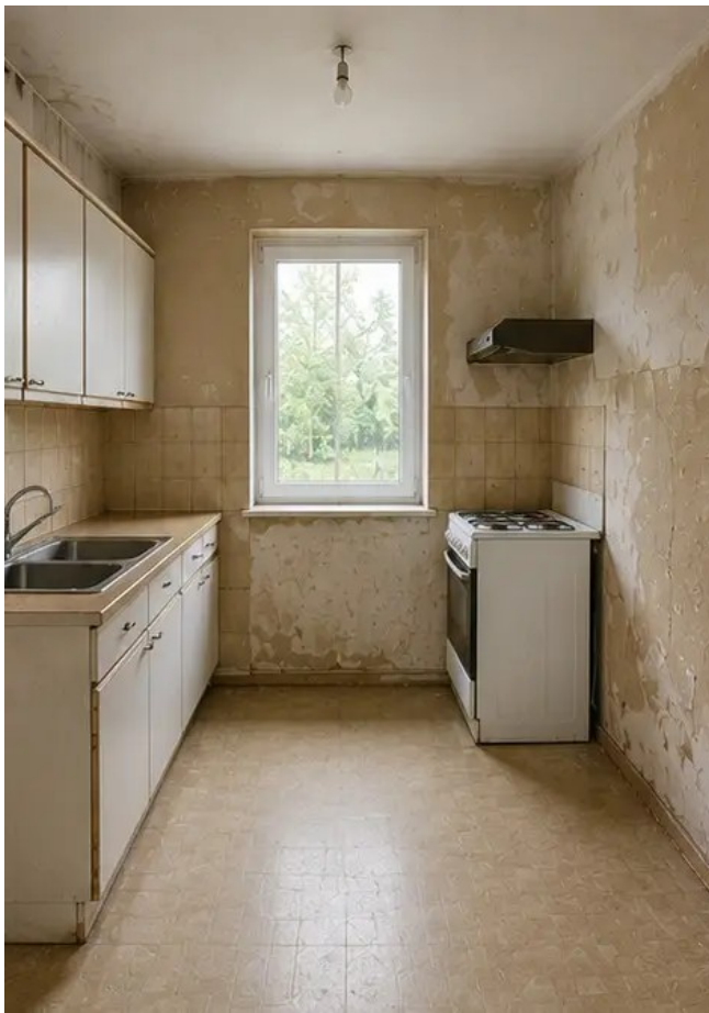
Dokumentacja fotograficzna №11 Stan kuchni przed remontem
