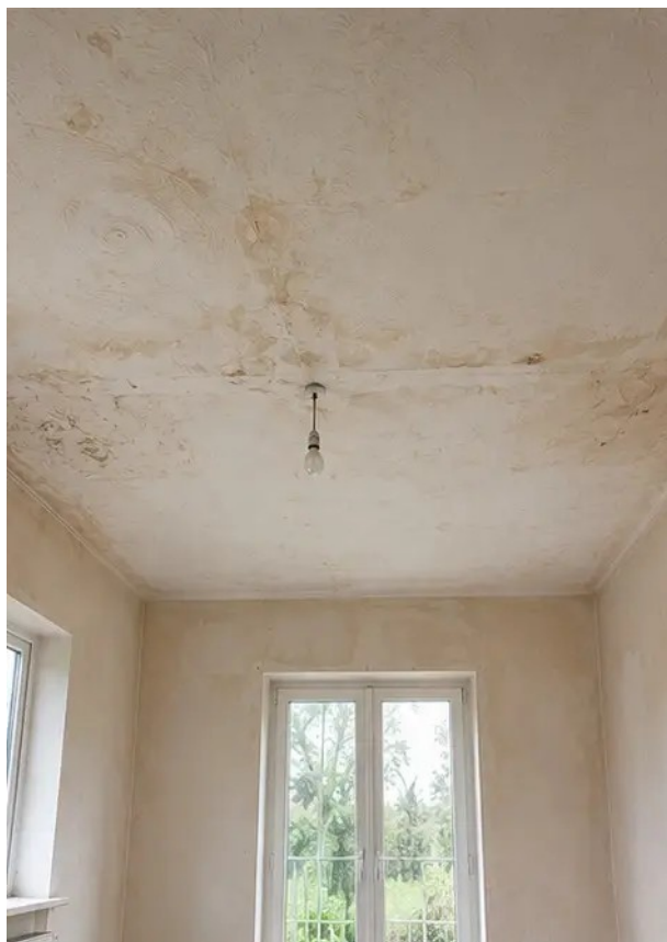
Dokumentacja fotograficzna №7 Stan sufitu przed remontem
