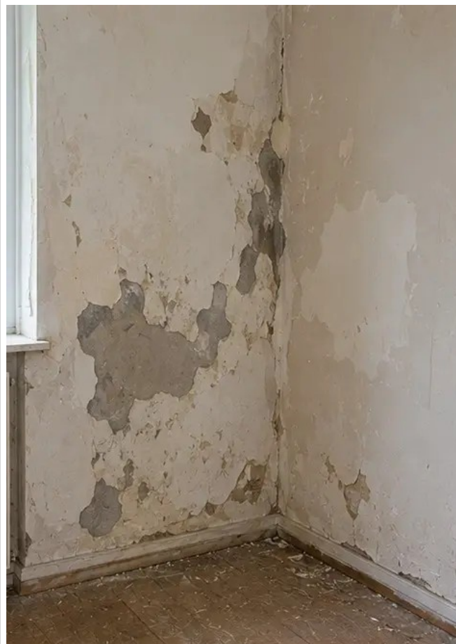
Dokumentacja fotograficzna №3 Stan ściany przed naprawą
