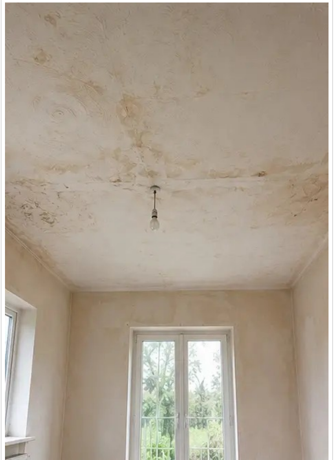
Dokumentacja fotograficzna №7 Stan sufitu przed remontem
