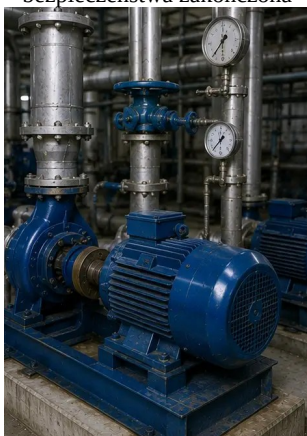
Dokumentacja fotograficzna №15. Urządzenia działają normalnie po konserwacji
