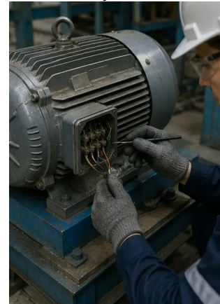
Dokumentacja fotograficzna №4. Inspekcja silnika elektrycznego zakończona
