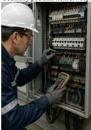
Dokumentacja fotograficzna №5. Przeprowadzona inspekcja szafy elektrycznej
