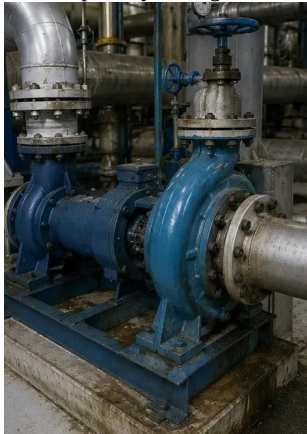
Dokumentacja fotograficzna №3. Stan pompy przemysłowej oceniony podczas konserwacji
