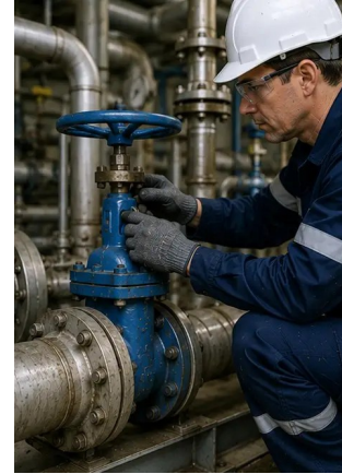
Dokumentacja fotograficzna №10. Stan zaworu oceniony podczas inspekcji
