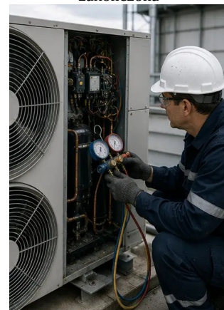
Dokumentacja fotograficzna №6. Stan urządzeń HVAC udokumentowany
