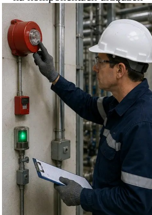
Dokumentacja fotograficzna №13. Inspekcja systemu bezpieczeństwa zakończona
