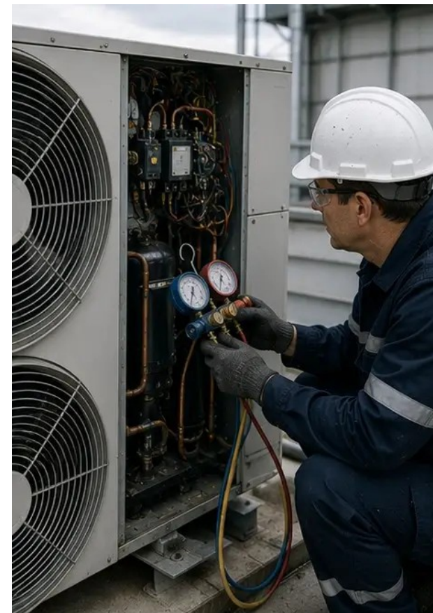
Dokumentacja fotograficzna №6. Stan urządzeń HVAC udokumentowany
