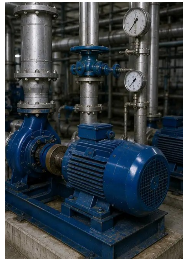
Dokumentacja fotograficzna №15. Urządzenia działają normalnie po konserwacji
