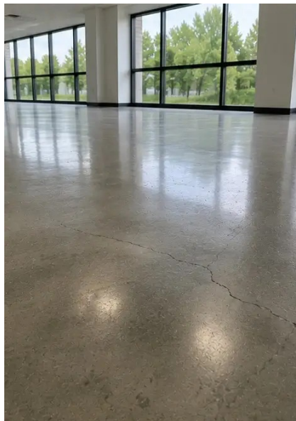
Photo #14. Stan podłogi oceniony i odnotowany
