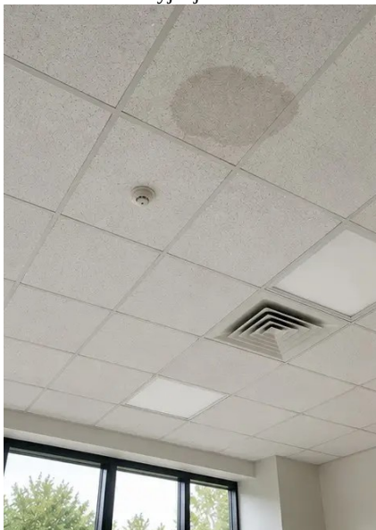
Photo #13. Stan sufitu udokumentowany podczas inspekcji
