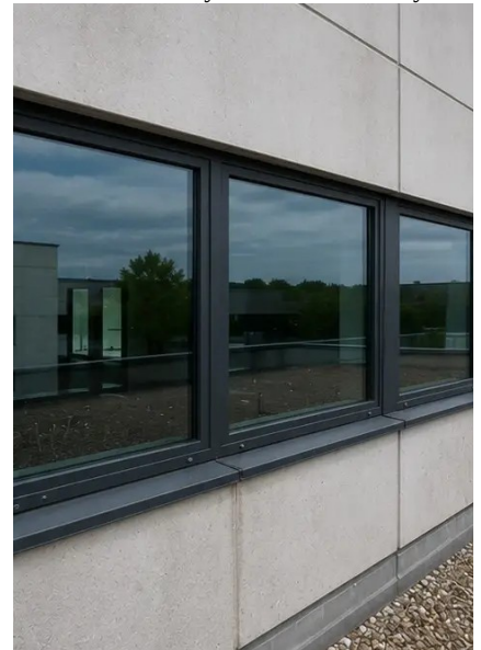
Photo #6. Stan okien udokumentowany podczas inspekcji
