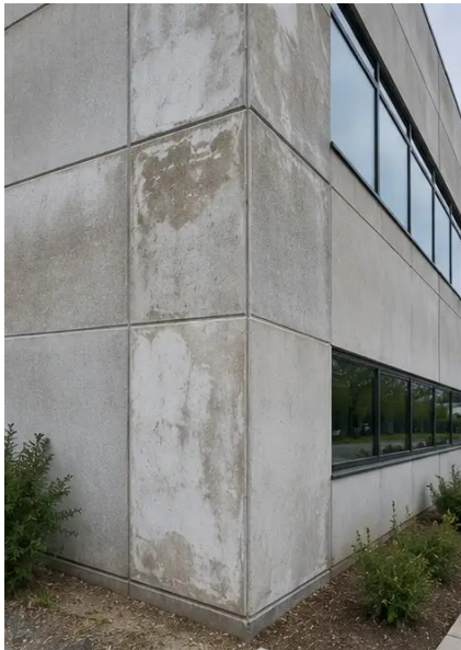
Photo #4. Stan ścian zewnętrznych odnotowany podczas inspekcji
