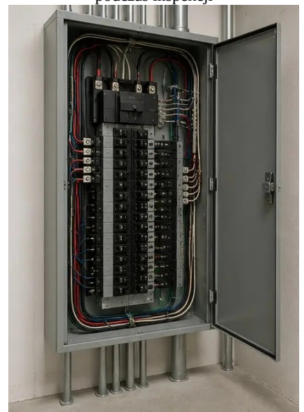
Photo #9. Stan rozdzielnic elektrycznej udokumentowany
