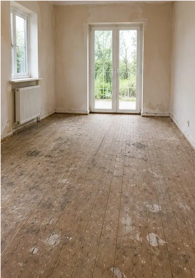
Foto №5 Staat van de vloer voor de vervanging
