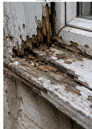
Photo #14. Detailfoto van vastgestelde schade als bewijs
