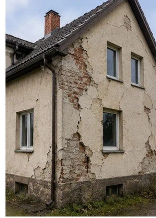
Photo #2. Overzicht van externe schade gedocumenteerd tijdens de inspectie
