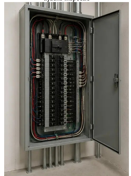
Photo #9. Staat van de elektrische verdeelkast gedocumenteerd
