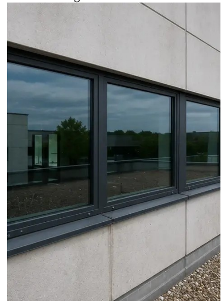
Photo #6. Staat van de ramen gedocumenteerd tijdens inspectie
