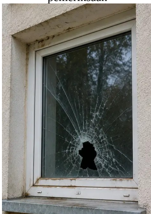
Photo #7. Tingkap rosak didokumenkan untuk penilaian
