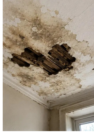
Photo #10. Kerosakan siling dikenal pasti dan direkodkan
