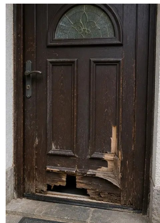
Photo #8. Pintu masuk rosak direkodkan semasa pemeriksaan
