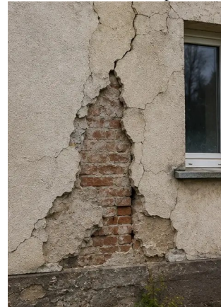
Photo #4. Kerosakan dinding luar didokumenkan untuk penilaian
