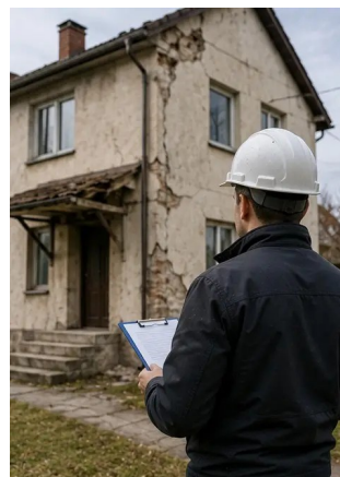
Photo #16. Gambar ringkasan pemeriksaan kerosakan akhir
