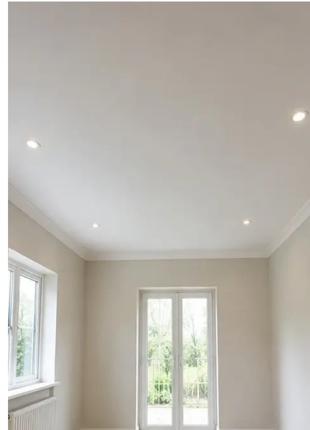
Foto No8 Keadaan siling selepas pengubahsuaian
