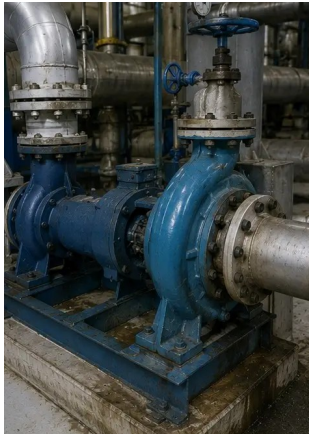
Foto №3. Keadaan pam industri dinilai semasa penyelenggaraan
