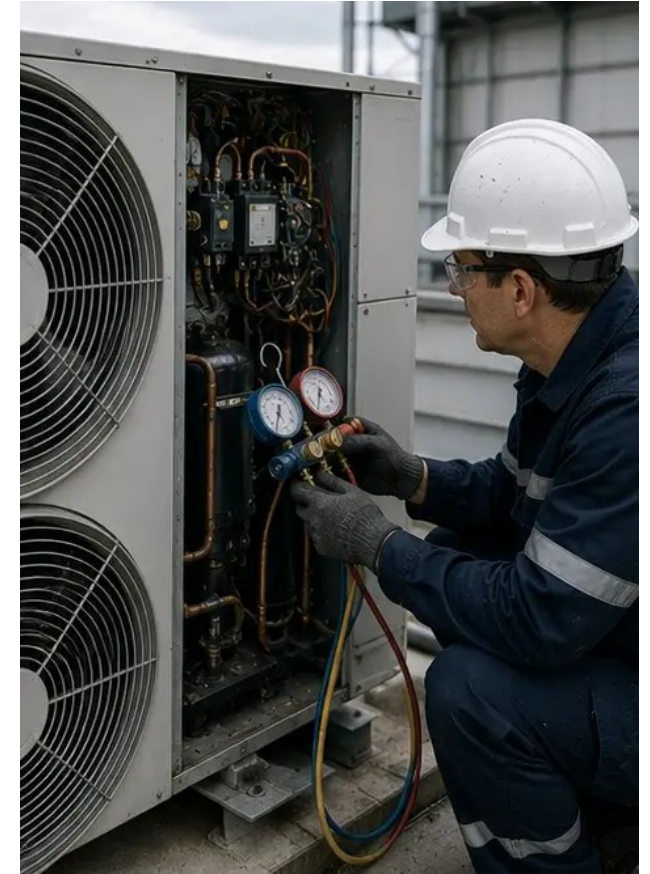
Foto №6. Keadaan peralatan HVAC didokumentasikan
