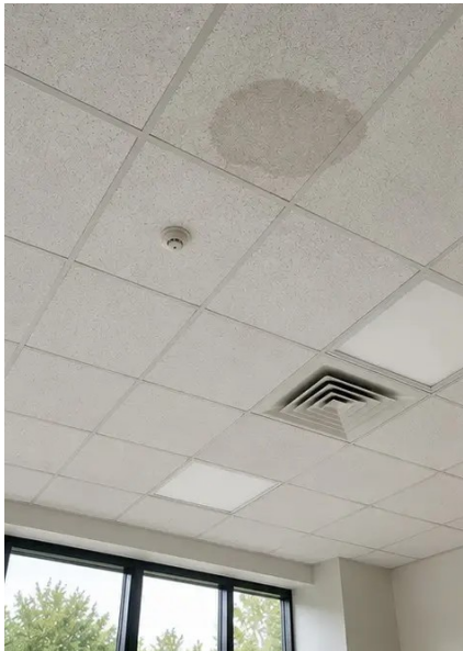
Photo #13. Keadaan siling didokumenkan semasa pemeriksaan
