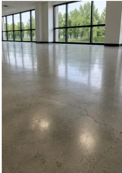
Photo #14. Keadaan lantai dinilai dan direkodkan
