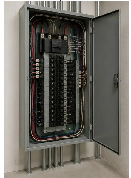
Photo #9. Keadaan panel elektrik didokumenkan
