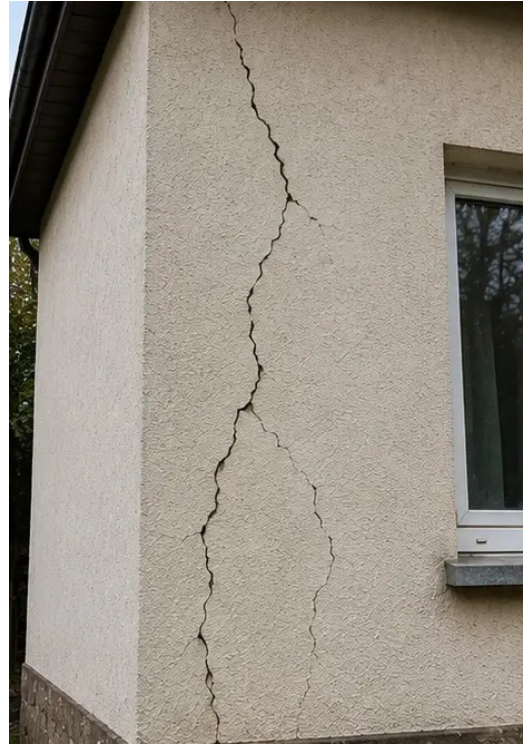
写真 №5 調査中に記録された構造壁のひび割れ
