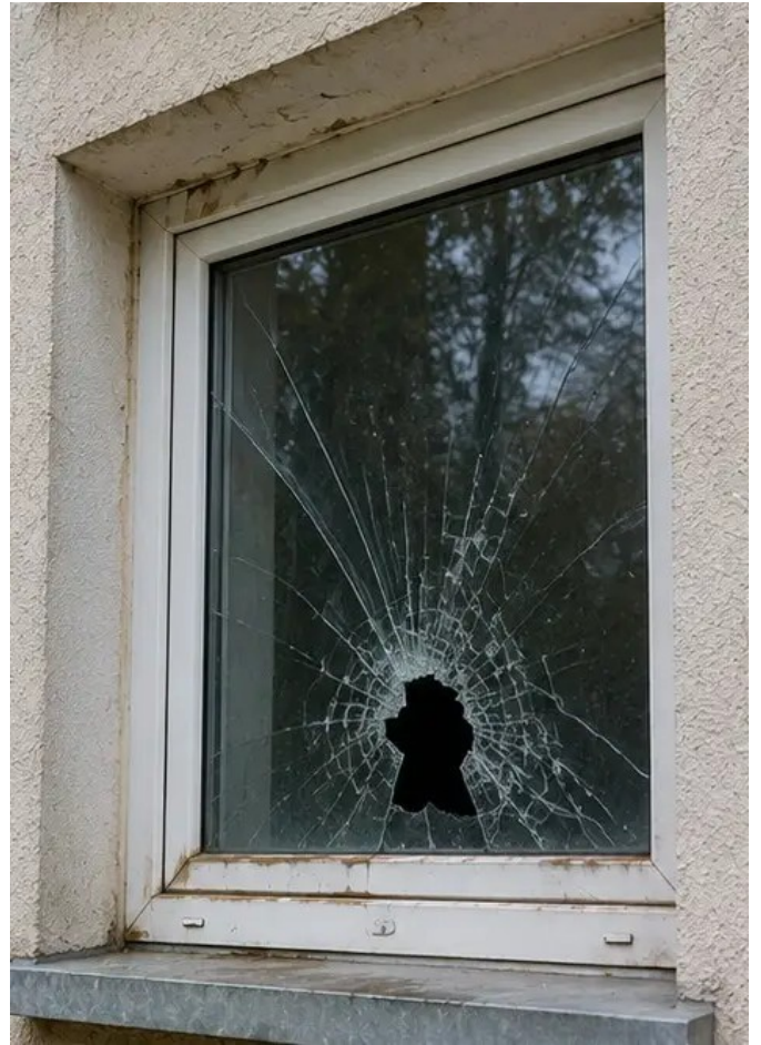
写真 №7 評価のために記録された損傷した窓
