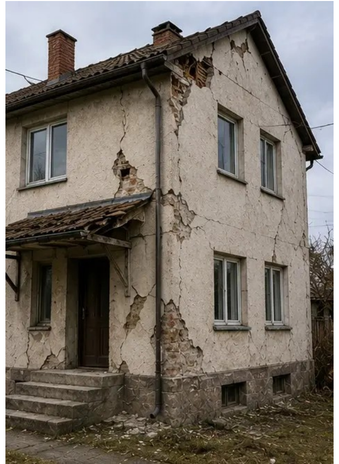
写真 №15 複数の損傷箇所の概要
