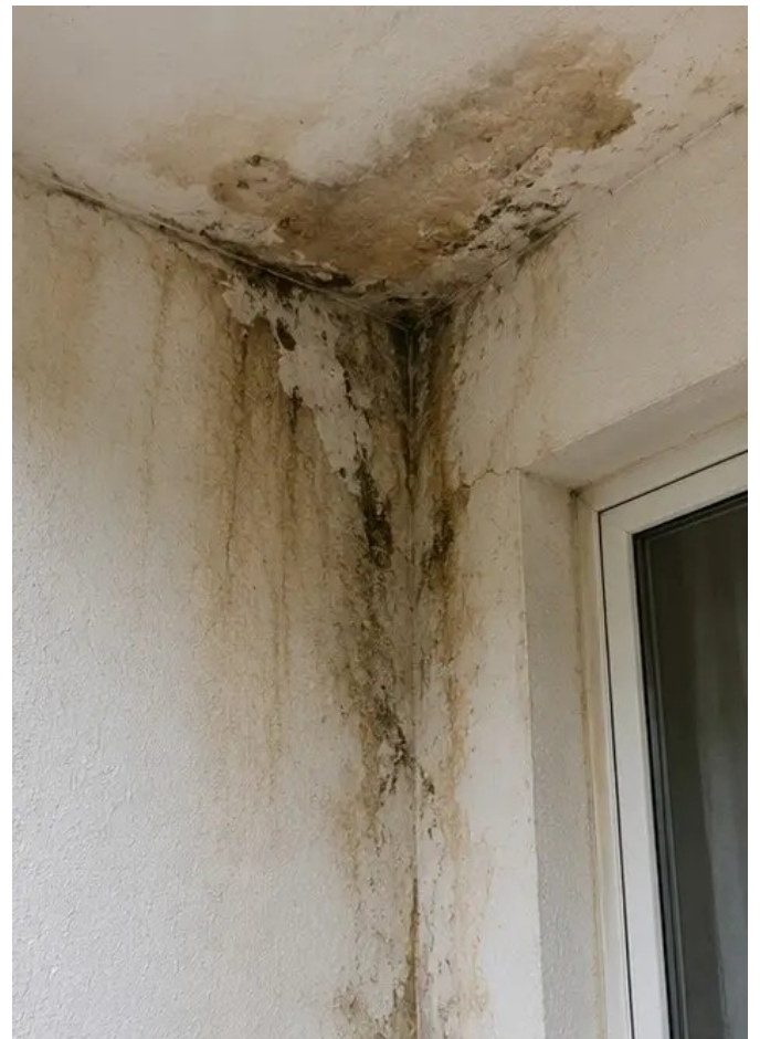
写真 №6 特定され記録された水害エリア
