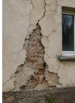
Photo #4. 評価のために記録された外壁損傷
