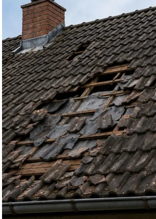
Photo #3. 特定され記録された損傷した屋根部分
