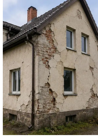
Photo #2. 調査中に記録された外部損傷の概要
