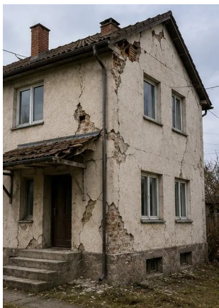
Photo #15. 複数の損傷箇所の概要
