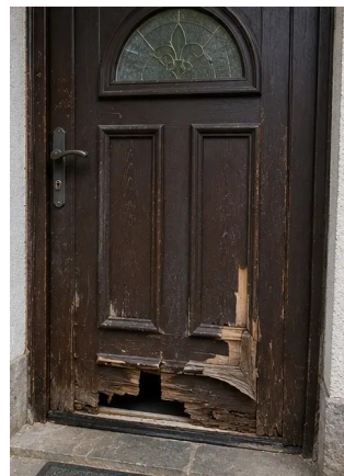
Photo #8. 調査中に記録された損傷した玄関ドア
