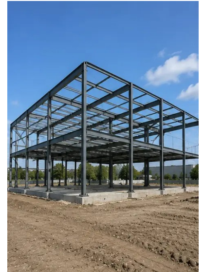
写真 №8. プロジェクトスケジュール通りに 構造フレーム完成
