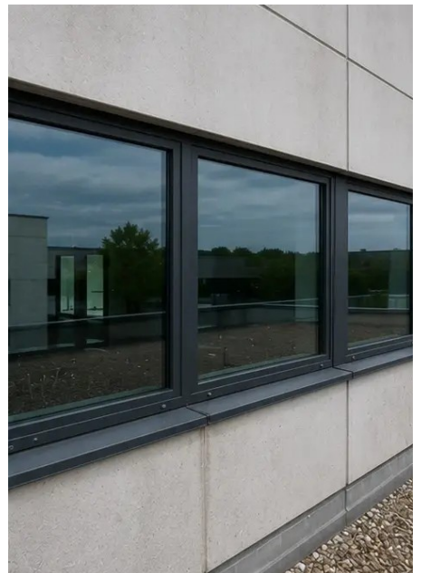
Photo #6. 調査中に記録された窓の状態
