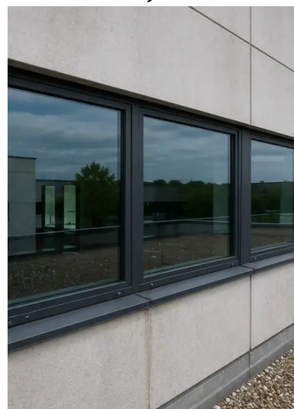
Photo #6. 調査中に記録された窓の状態
