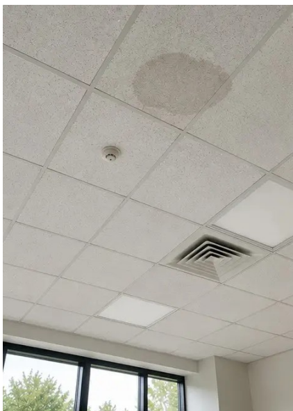
Photo #13. 調査中に記録された天井の状態
