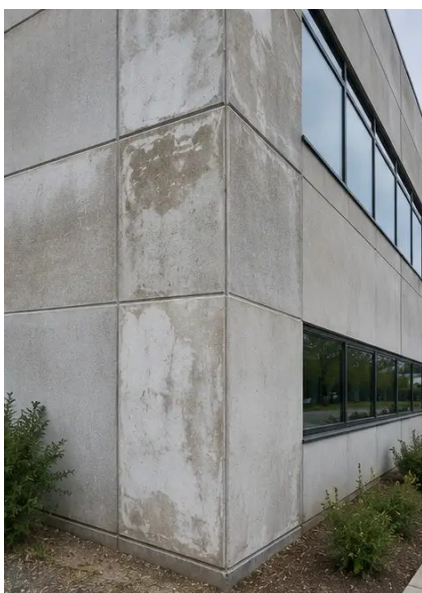
Photo #4. 調査中に記録された外壁の状態
