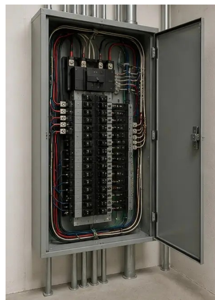
Photo #9. 記録された電気パネルの状態
